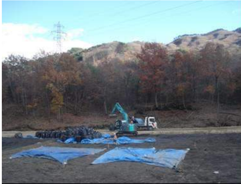
写真4. 飯舘村村内農地には除染後の汚染廃土一時仮置き場が点在（2013年11月21日撮影）
